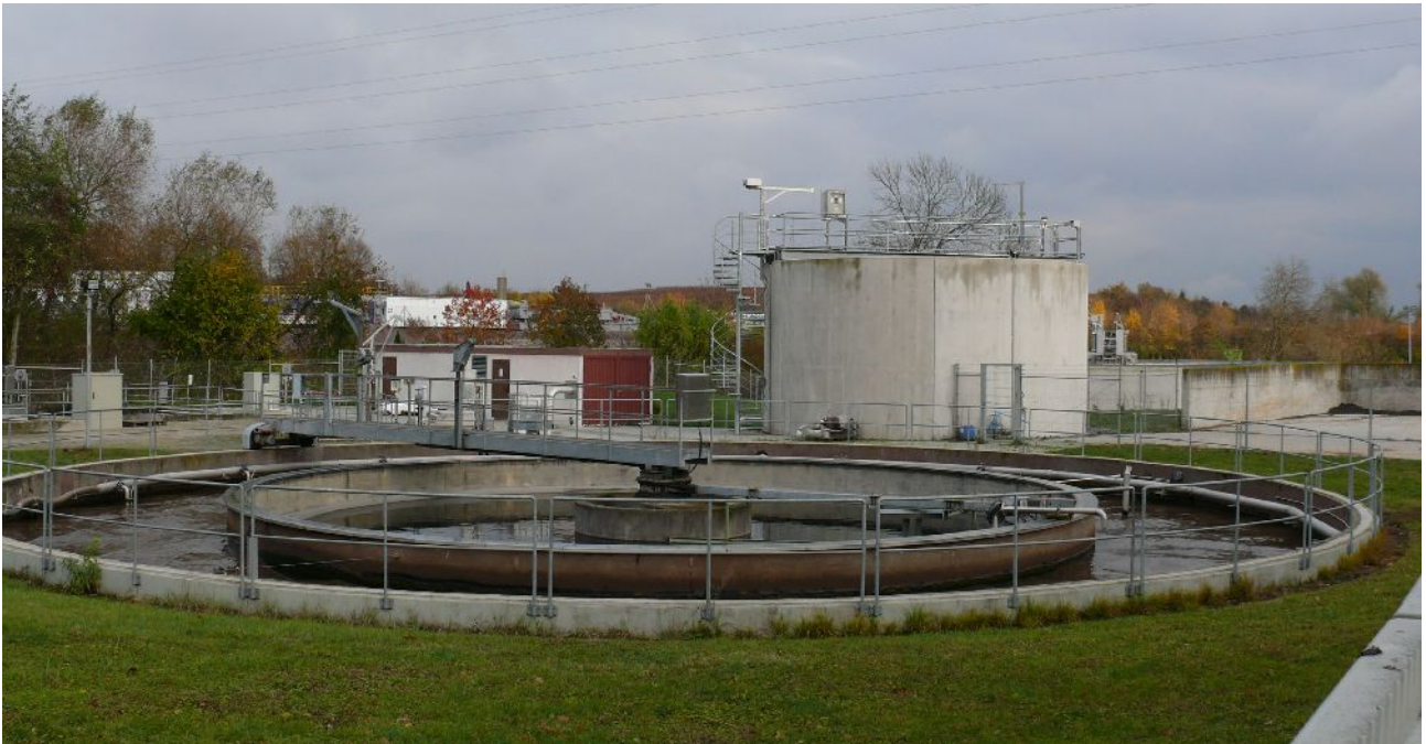
Klärbecken und Schlammsilo der erweiterten Kläranlage
